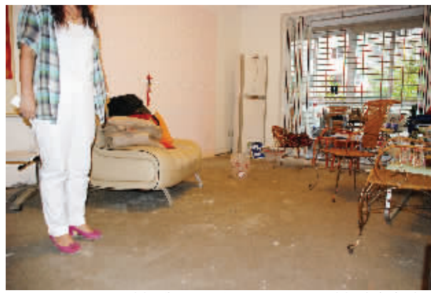
由于家中地板遭污水泡坏,谭女士已将地板全部起出。
