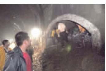
因雨水冲刷,导致泥石流从隧道通风口灌进隧道。图为隧道通风口,抢险人员正在紧张施工。
