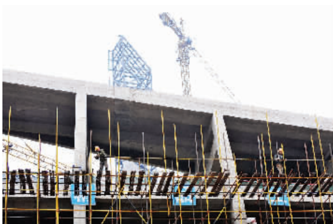
4月16日下午,长沙市新河三角洲,几名施工人员在搭建脚手架。据了解,“两馆一厅”要等到明年才能建成开放。 记者 田超 摄
