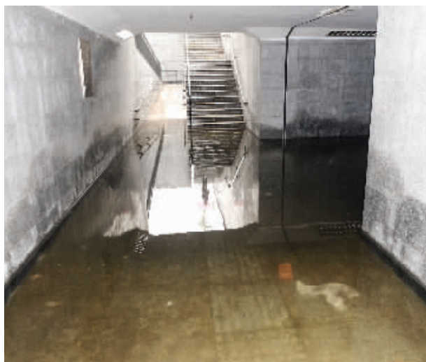
4月12日,长沙市书院南路广厦新村附近,未完工的地下通道积满了水。 记者 龚磊 摄
