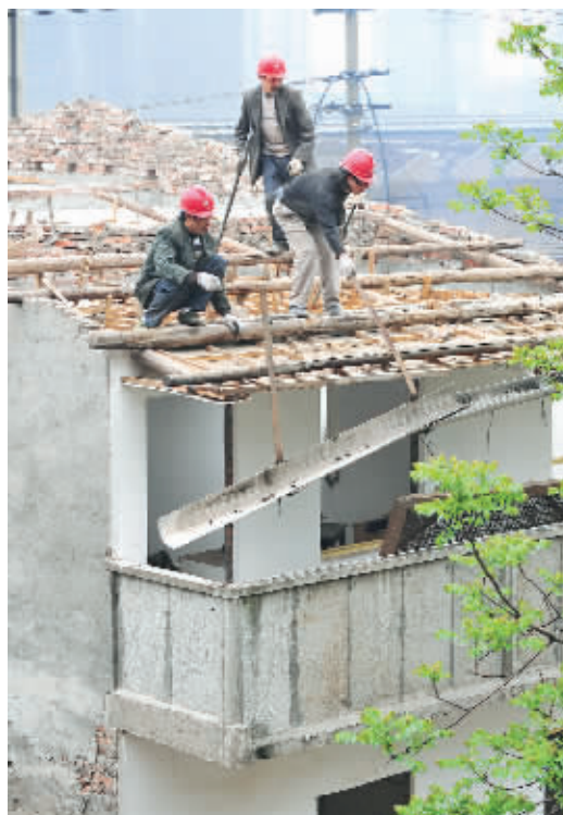
4月12日上午,长沙市芙蓉中路新北站巷,几名工作人员在拆除铁路边的几栋住宅。
