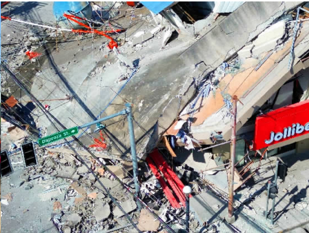
这是6月8日在菲律宾桑托斯将军城拍摄的被震毁的建筑(无人机照片)。 新华社图
