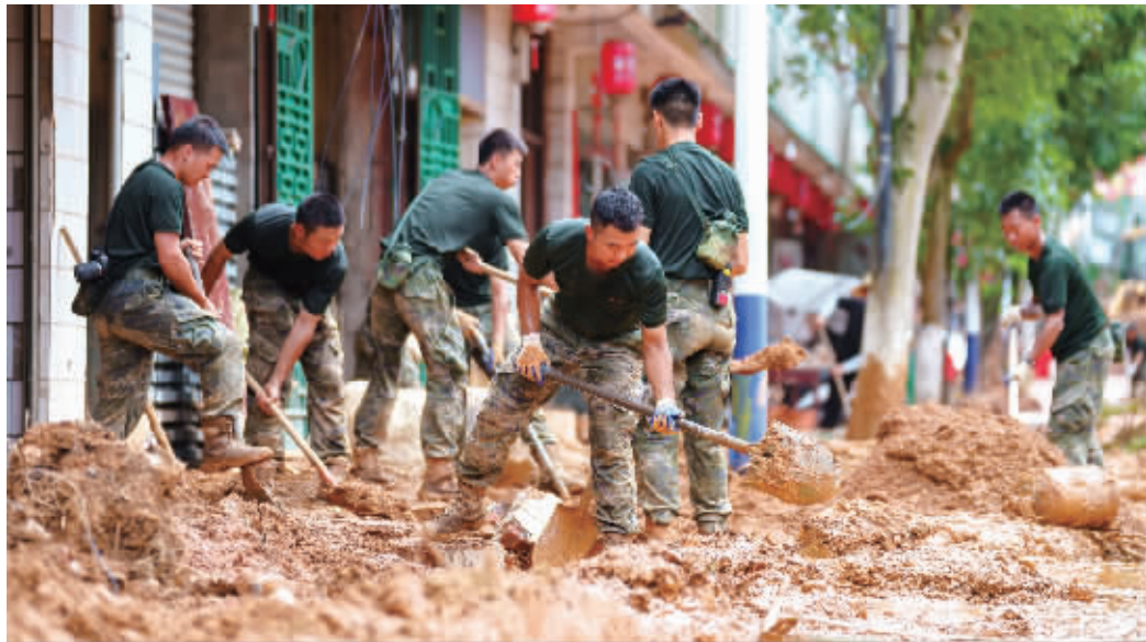
8月1日，武警官兵在开展清淤作业。当天，武警湖南总队郴州支队出动70余名兵力，前往资兴市八面山瑶族乡018县道帮助当地群众清理淤泥。张森摄
