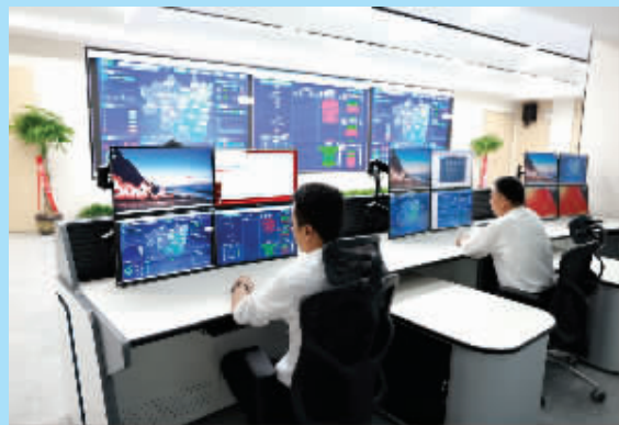
变电集控站值班员采用远程智能巡视系统
