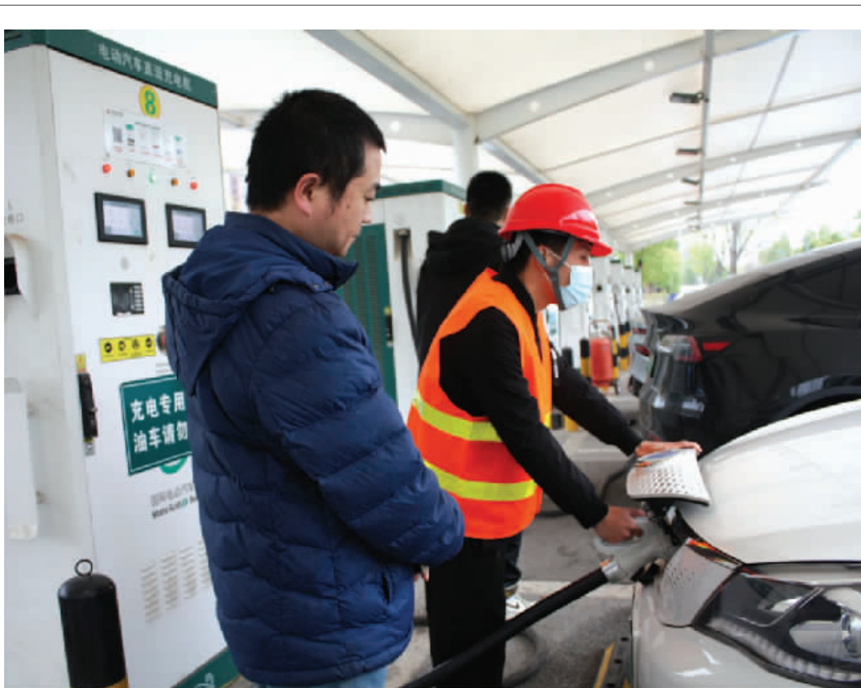
国网湖南电动汽车服务有限公司坚持“人民至上、生命至上”的安全发展理念,坚持“安全第一,预防为主,综合治理”的安全生产方针,落实落地“用心尽责,共享平安”的安全生产文化,强化“管业务必须管安全”要求,大力营造安全齐抓共管、严抓严管的良好氛围,严格人员履职尽责,严控风险隐患,严守人身安全底线。图为3月20日,长沙圭塘河二号停车场充电站正处于充电高峰期,运维人员到场站进行安全检查的同时为充电车主进行充电服务和现场安全告知。
