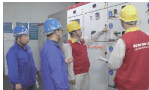
国网桃江县供电公司桃江供电服务站的工作人员正在检查电力设备。 通讯员 供图
