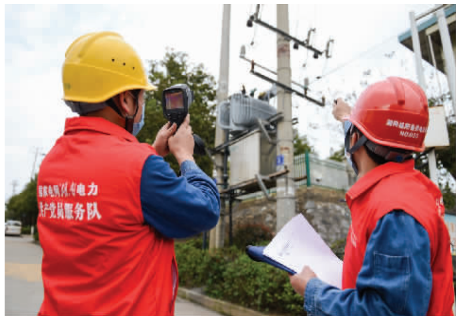
国网桂阳县供电公司开展台区测温，保障供电安全，服务乡村振兴。
