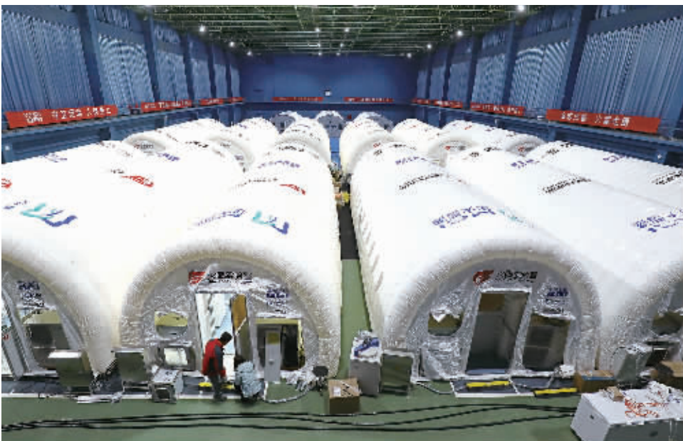
1月8日，工作人员在安装调试“火眼”实验室设备。当日，日检测通量10万单管的“火眼”实验室（气膜版）经过连夜建设，在石家庄市河北体育馆网球馆亮相。目前，工作人员正在加紧安装调试设备，投入运行后每日最高可检测核酸样本量100万人份。 新华社 图
