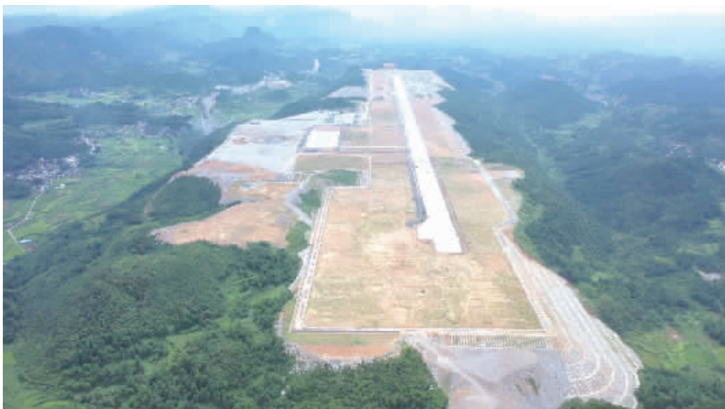
截至目前，湘西机场路基完成81%，桩基工程完成92.2%。图为建设现场。 通讯员 供图
