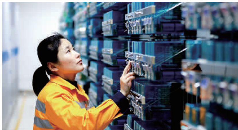
1月29日凌晨，长株潭城际铁路荷塘站，卢芳正在测试机械室的设备。 记者 和婷婷 摄
