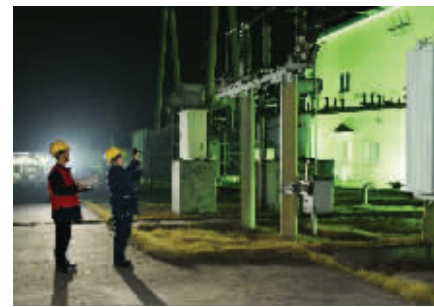
春节期间,巡视人员开展夜间红外测温。
