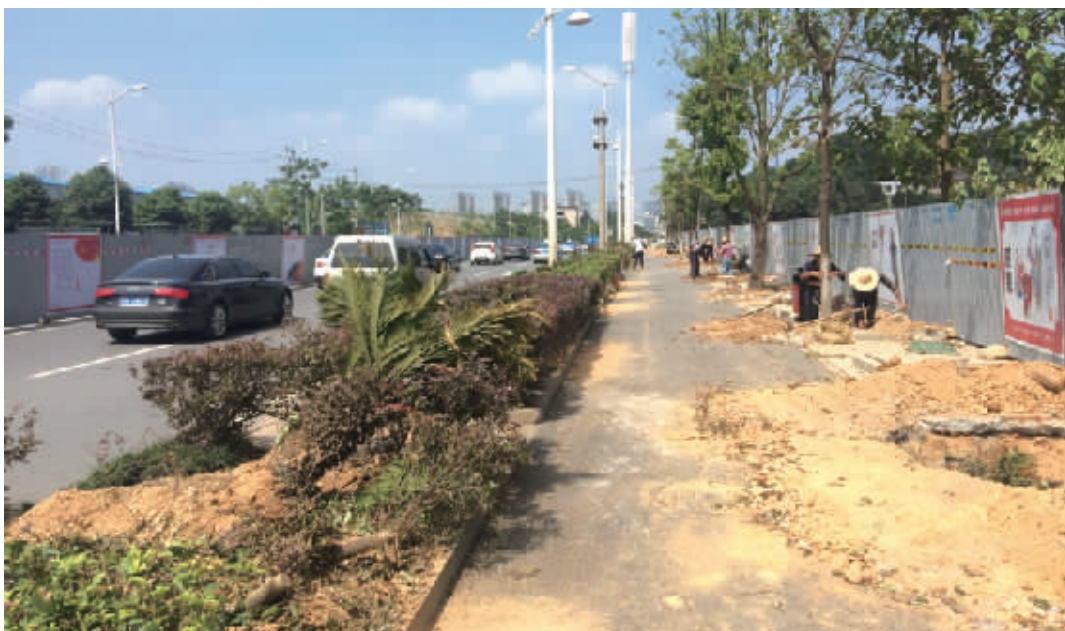
长沙开福区福元西路，几名园林工人正在对人行道上的树木进行挖掘移植。 记者 丁鹏志 摄
