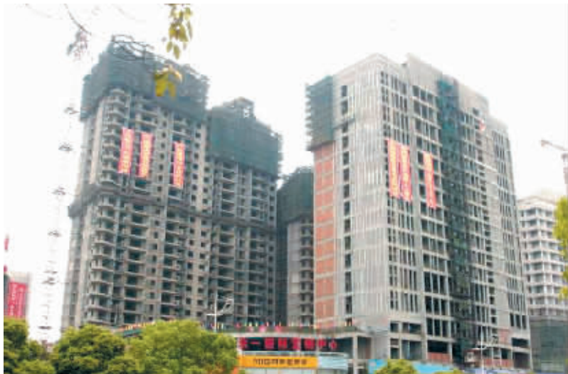
李湘铭被抓后，湘潭众一国际工地彻底停摆。
