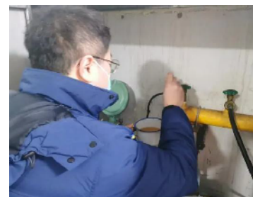
工作人员排查燃气安全隐患。
