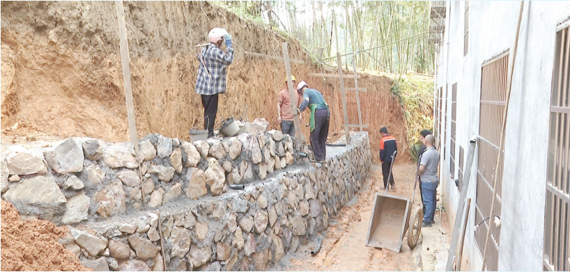
汝城县南洞乡光明村二组切坡建房隐患治理点位。(郴州市自然资源和规划局供图)
