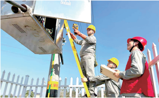
供电公司工作人员在果园巡视供电设备。魏艳 摄
