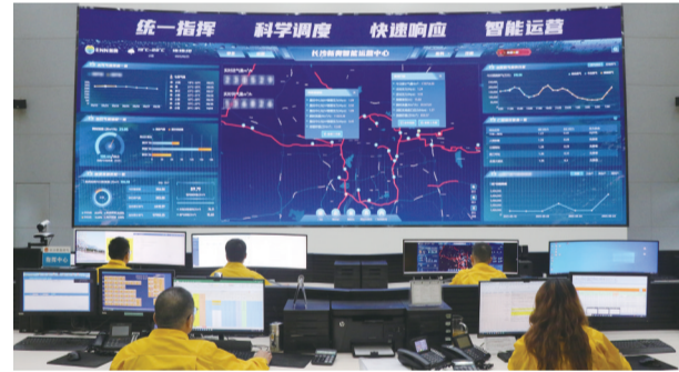
调度中心实时监测全市燃气管网运行情况。
