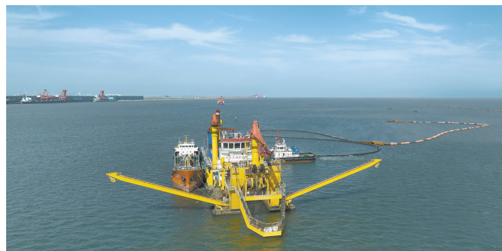
10月8日,施工船在河北省唐山港京唐港区第四港池25万吨级航道工程建设工地施工。据介绍,该工程是交通运输部重点工程,总投资约9亿元。项目建成后,将有效提升港区船舶通过能力和通航安全水平。新华社发
