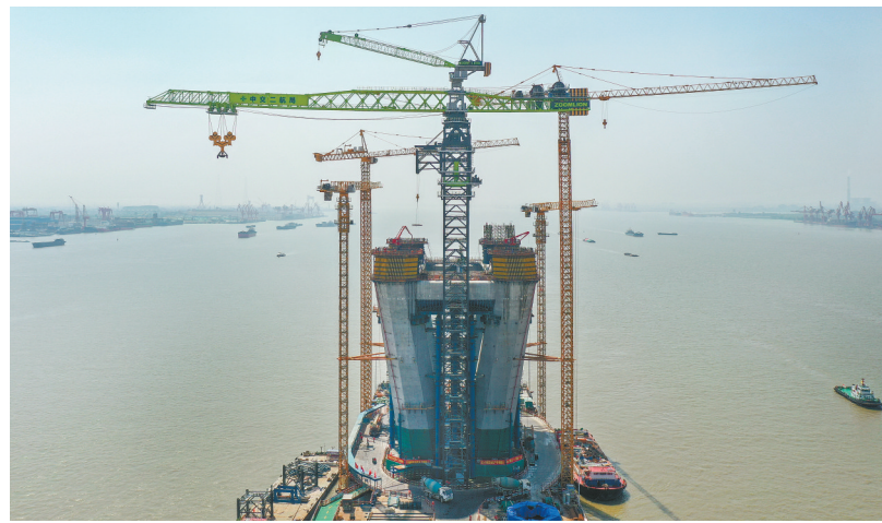
6月2日,江苏省常州(州)泰(州)长江大桥施工现场,中联重科万吨米级塔机顺利完成立塔、安装、调试。 通讯员 摄
