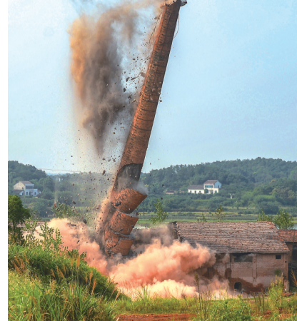
经济要发展，杜绝污染是前提。图为澧县一家粘土砖厂的烟囱被爆破。马骏 摄
