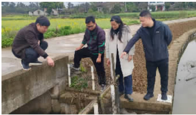
澧南镇松林村派驻纪检员张俊(右一)查看该村张家堰涵管安装是否达标。 湖南法治报通讯员 向伟 摄
