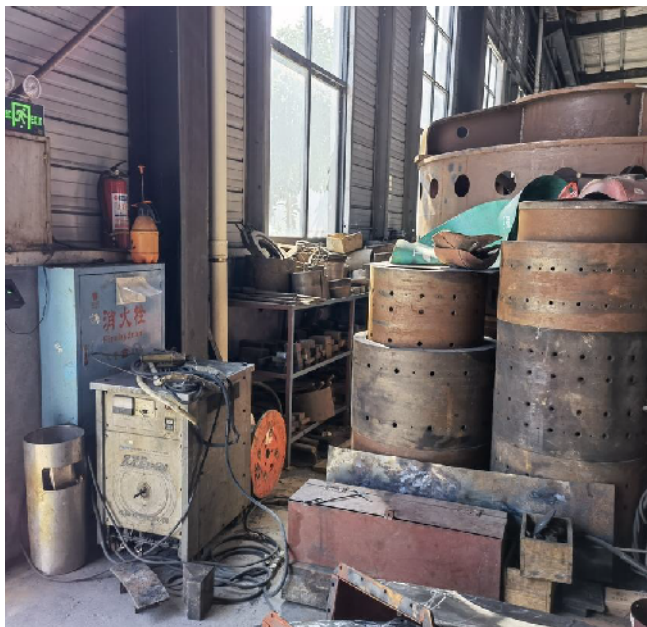
杂物遮挡消防栓。
