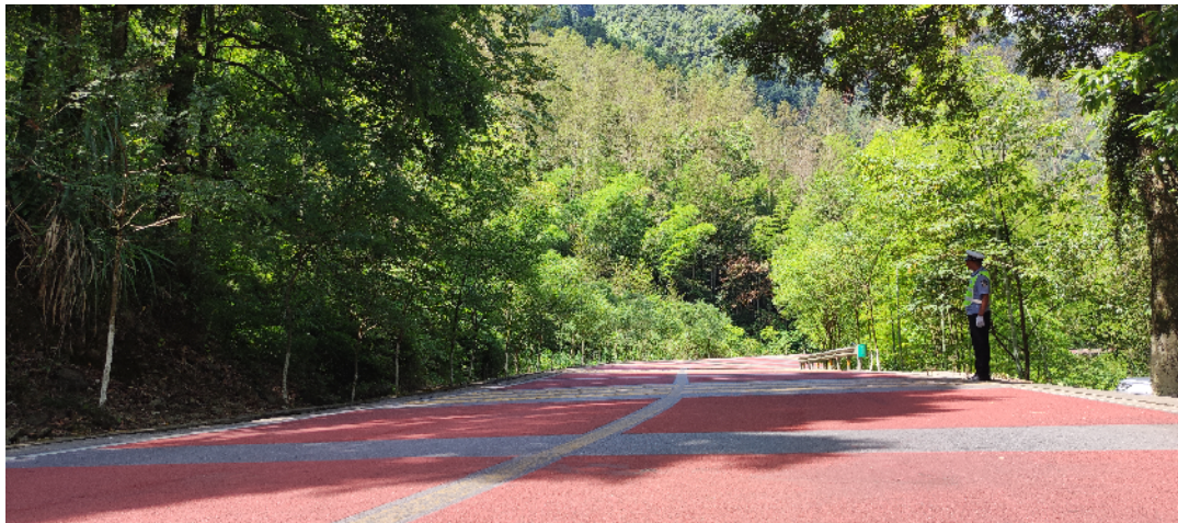
整改后的致命弯道。
