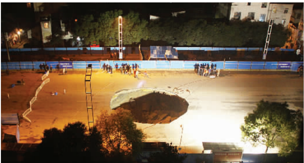
11月29日晚,营盘路隧道东引道发生涌沙流泥,造成路面坍塌。 记者 李丹 摄
