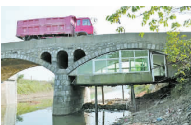
湘潭县梅林桥镇竹山村向东桥下,悬空搭建的房子已有16年。
