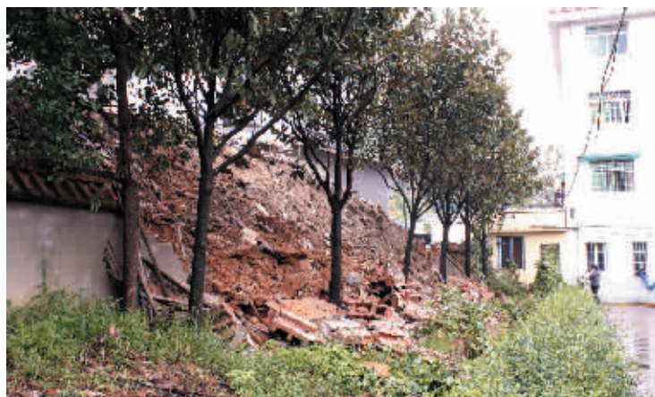
9月28日,长沙金苑花园小区与隔壁海林·馨香雅苑小区相隔的围墙垮塌了十余米,墙边是成堆的垃圾。 卿进元 摄
