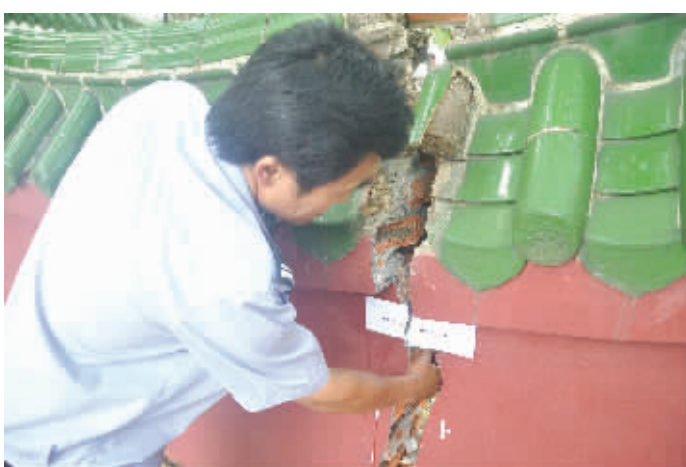
9月9日,长沙市雨花区洞井铺镇的中铁五局一公司。公司院子里的墙上裂开了很大的缝隙,可以塞进整只手臂。
