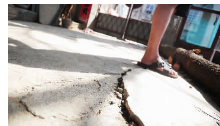
院子靠外墙地面已严重向下倾斜，部分地面裂缝已有两指多宽。
