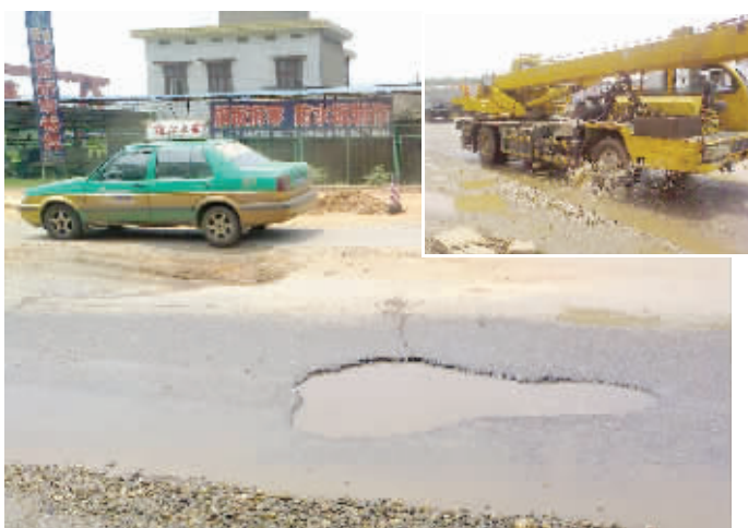
雨花区大托镇披塘村的这条路,坑坑洼洼,破败不堪。
