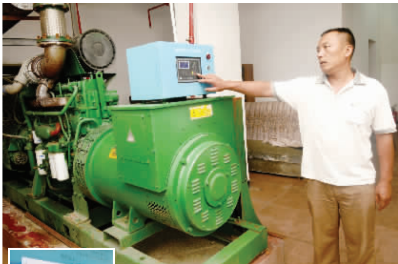
8月12日,长沙市万煦园小区,大当家物业公司工程部主任徐跃辉保证,停电十分钟内小区的柴油发电机一定会启动。 记者 龚磊 摄
