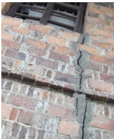
墙上裂缝用水泥糊过，但越来越明显。
