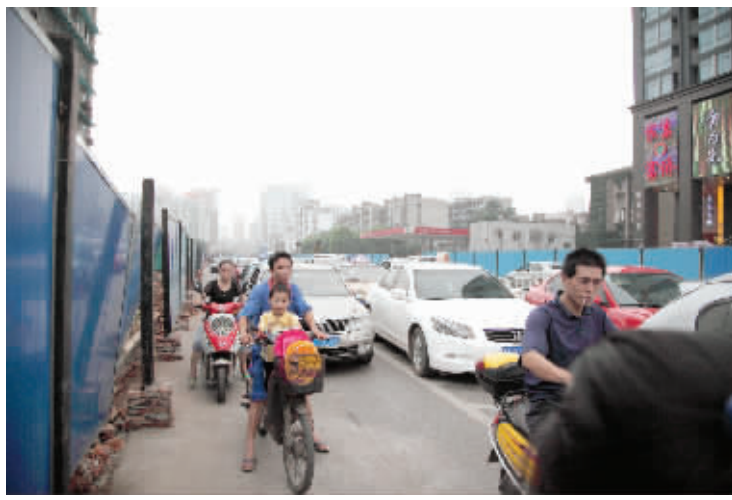
7月12日下午,因为地铁施工,在黄兴路与营盘路交会处,路面出现拥堵现象。 ■实习生 邓天佑 记者 武席同 摄
