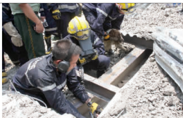
7月5日，厦门一在建钢结构建筑倒塌造成3死3伤。新华社图
