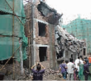
倒塌的安居房。
