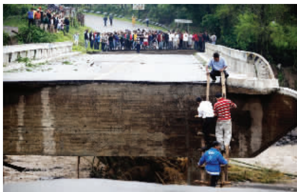
当地时间5月30日，在危地马拉首都危地马拉城，连续降雨造成路面塌陷。
