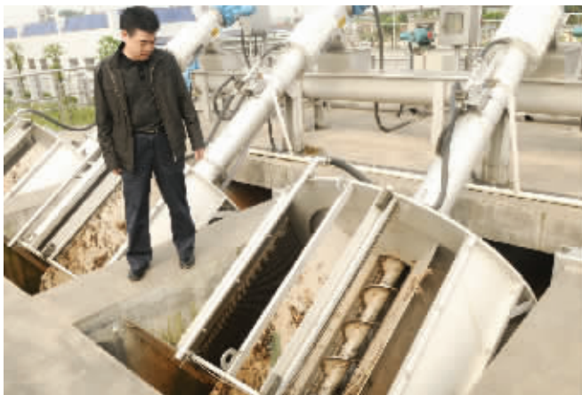
5月20日,长沙市新开铺污水处理厂,长沙市环保局工作人员在检查该厂污水处理设备的运行情况。 记者 龚磊 摄
