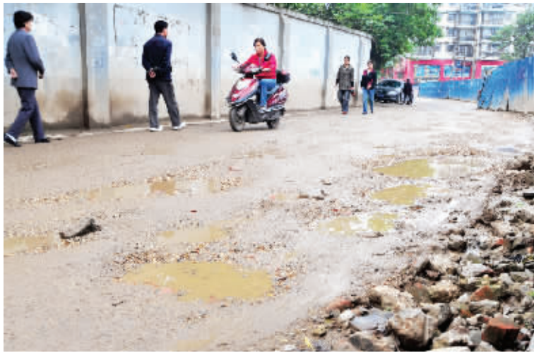
5月17日下午,长沙市德雅路才子佳苑附近,路面坑坑洼洼,破损严重,路过的机动车和行人只好紧靠西侧行进。 记者 田超 摄
