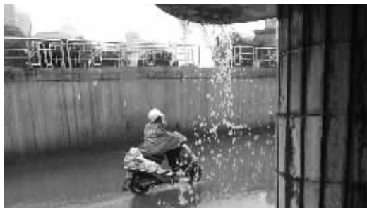
4月21日,芙蓉路立交桥下,桥上层的水往下流淌,在下层积水洼。 记者 龚磊摄
