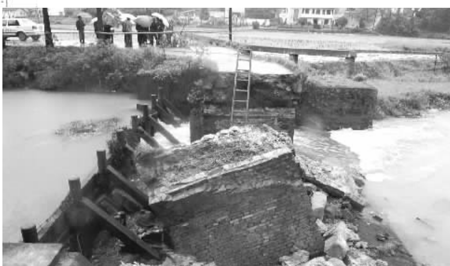
4月21日,长沙市岳麓区莲花镇云盖村,垮塌的富家桥引起村民的围观。记者 魏灿 摄
