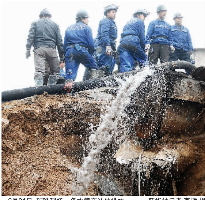
3月31日,矿难现场一条水管在往外排水。 新华社记者 燕雁 摄
