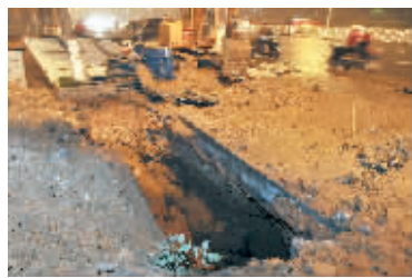
12月24日晚,长沙市潇湘大道阜埠河路口,2名正在铺设燃气管道的工人遭遇塌方,一死一伤。 记者 伍霞 摄
