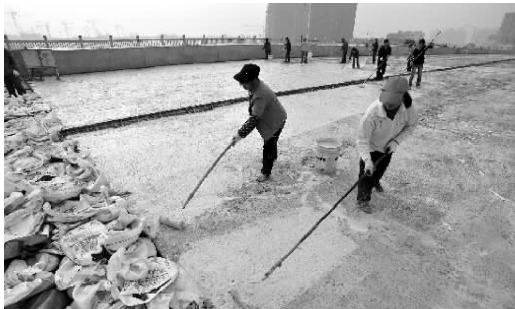
11月26日下午,长沙市芙蓉北路捞刀河大桥,几名施工人员在即将通车的主桥桥面刷防水涂层。
