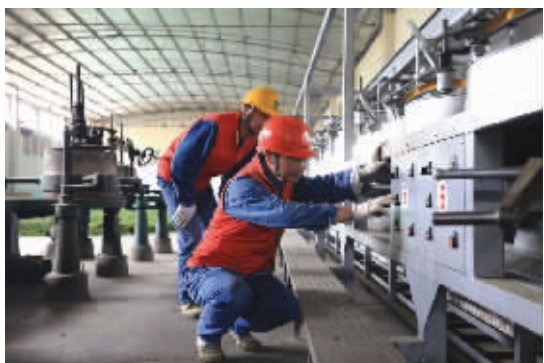
国网常德供电公司驻村工作队队长漆绍英协助茶厂检查设备。
