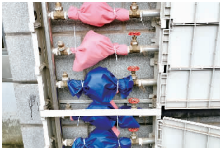
长沙某小区“一户一表”水改后新安装的水表。 受访者 供图
