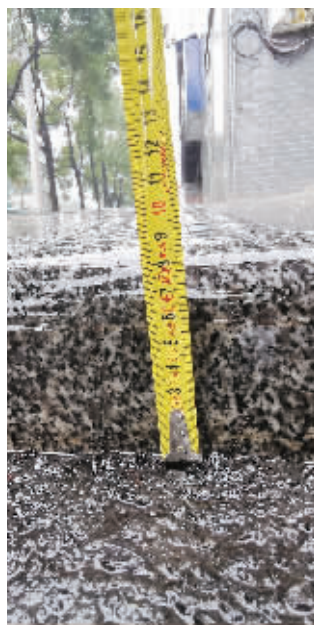
测量结果显示,竹园路路口处实地测量缘石坡道坡口与车行道的高差达到8厘米。 杨洁规 摄
