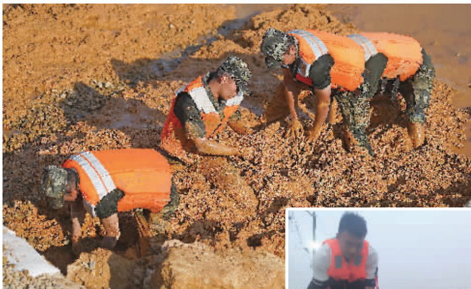
开挖导渗沟、填埋沙石、疏通排水渠、垒填沙袋，汗水划过脸颊，浸湿军装。江西省抗洪一线，武警战士在泥水中处置一处堤坝坍塌险情。20岁的退伍军人岳阳小伙张冻近日也加入鄱阳湖区抗洪队伍，成为他们的一员。
